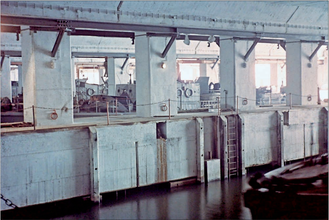
Abbildung 5: Für bessere Licht- und Sichtverhältnisse bei Wartungs- und Reparaturarbeiten bei Nacht ist das gesamte Innere des RBB Le Havre mit weißer Farbe ausgemalt worden. (Quelle: Marineschule Mürwik)
